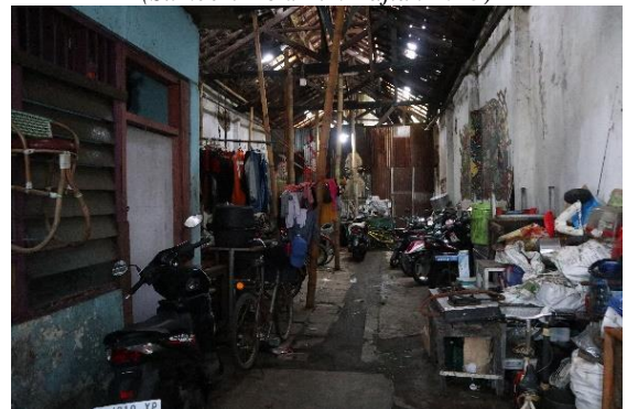
Gambar 4. 11. Suasana bagian dalam bekas RPH yang kini menjadi galeri seni dan tempat parkir (Sumber: Dok. Tim Kajian 2023)
